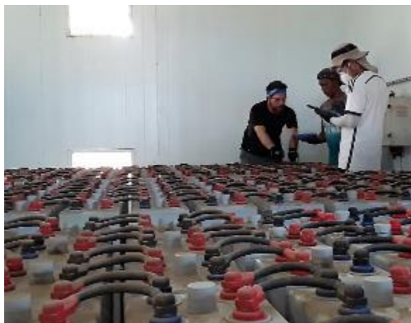
Gambar 15: Tim teknis NZMATES menguji baterai di PLTS di Lirang
