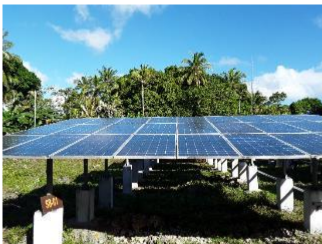
Gambar 24: PLTS yang rusak di Pulau Tiga
